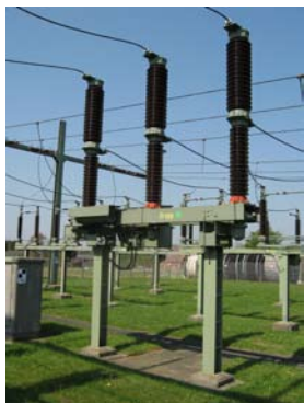
Foto des Leistungsschalters
